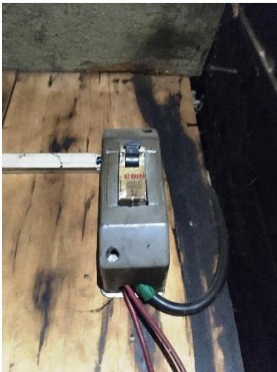
Hausanschluss mit Sicherung
